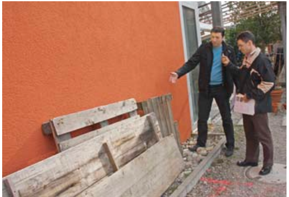
Auch davor warnt die Instandhaltungsanleitung: Das Anlehnen von Gegenständen an die Fassade kann zu Beschädigungen führen.
