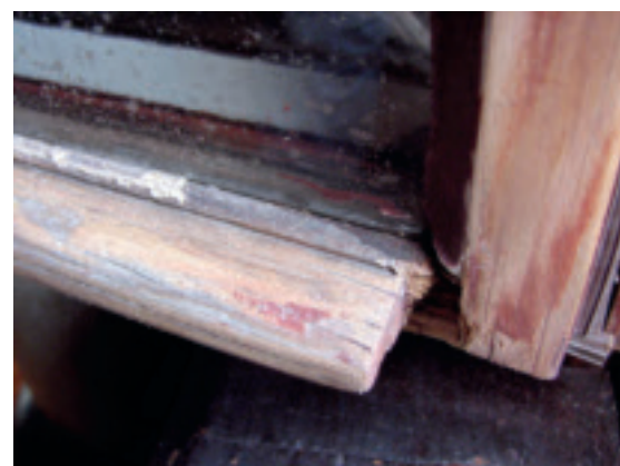
Verwittert: Stark lädierte Fensterschenkel mussten ausgetauscht werden.
