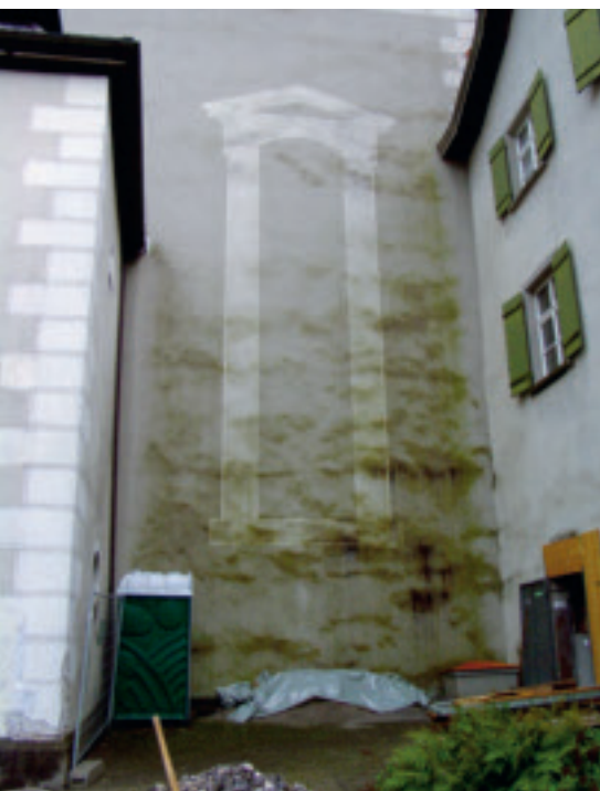
Die Fassade zeigte stellenweise starken Algenbefall.
