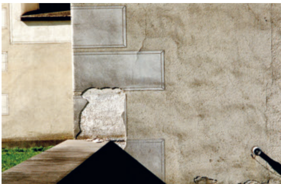
Der 1969 aufgebrachte Kunststoffputz platzte in grossem Ausmass ab.
