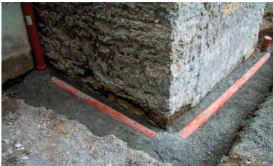
Im Fundamentbereich wurden Sickerleitungen eingebaut, die das Oberflächenwasser vom Mauerwerk fernhalten. (Foto: Wickli + Partner)
