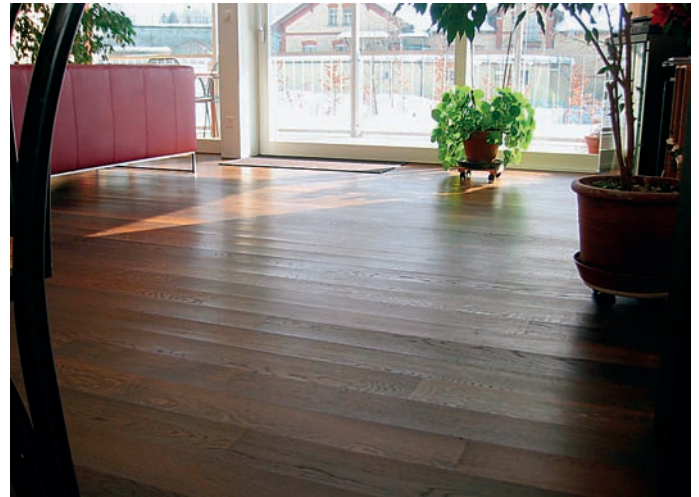
3 Wird ein Bodenbelag auf einem ungenügend ausgetrockneten Estrich verlegt, können teure Bauschäden eintreten wie hier dieses schüsselnde Parkett.
