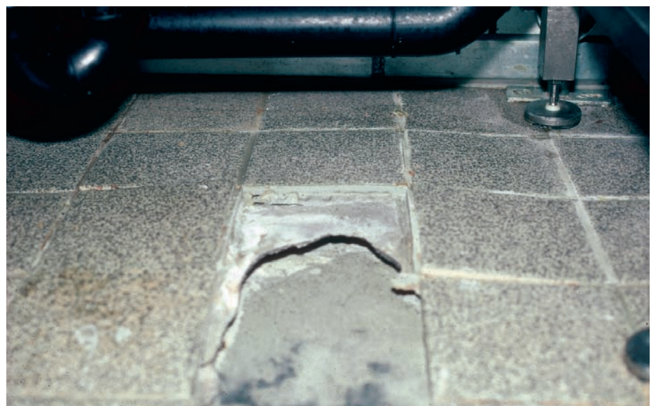
4 Calciumsulfat-Fliessestriche sind ungeeignet für Nassräume. Bei dieser Betriebsküche löste sich der Plattenbelag infolge Durchnässung des Calciumsulfat-Fliessestrichs grossflächig ab.
