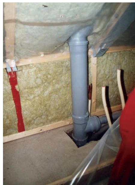
4 Hier ist es praktisch unmöglich, die Folie dauerhaft luftdicht an das Rohr und den Boden anzuschliessen.
