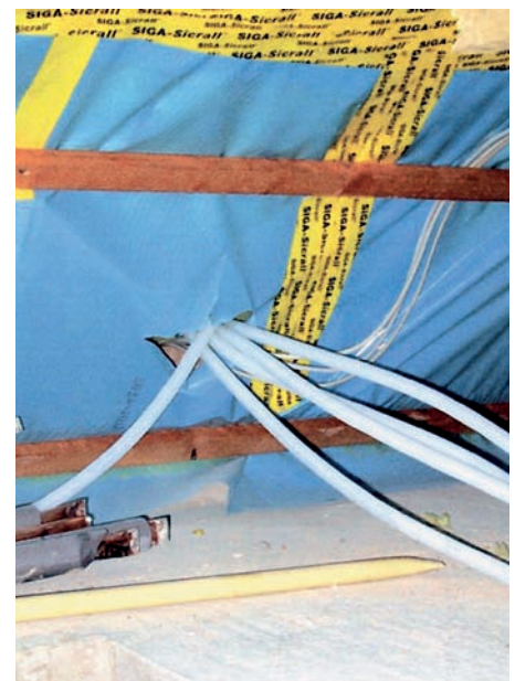
5 Die Elektroinstallation zerstörte hier nachträglich die Dampfbremse/Luftdichteitzebene.
