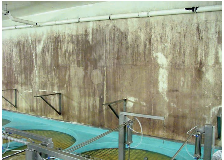
Auch Innenräume können von Pilzen befallen sein, z. B. wie hier bei Belastung durch Spritzwasser.
