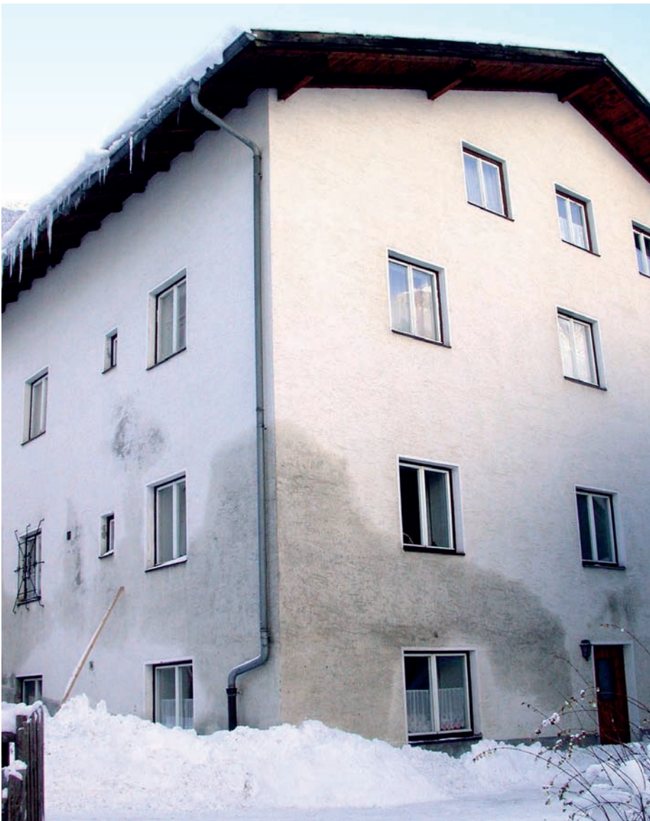
7 Der starken Nitratsalzbelastung der Fassadenputze dieses Gebäudes wurde bei der Sanierung keine Rechnung getragen, weshalb sich die Salze in den neuen Deckputz verlagerten und dort zu einer Feuchtebelastung führten.
