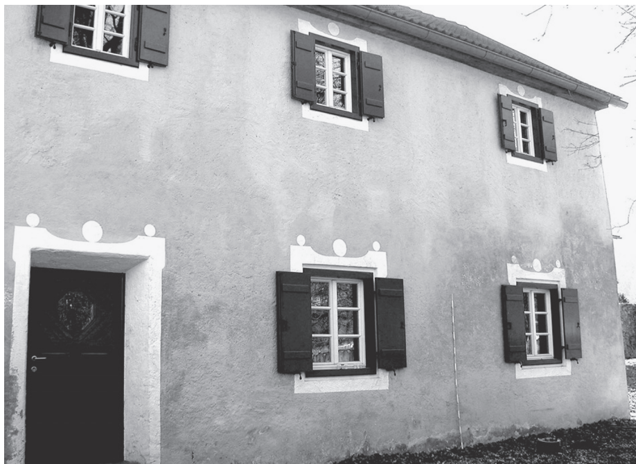
6 Die an der Fassade dieses Hauses optisch erkennbare Feuchte hat ihre Ursache in einer hohen Belastung der Baustoffe mit hygroskopisch wirksamen Salzen.
