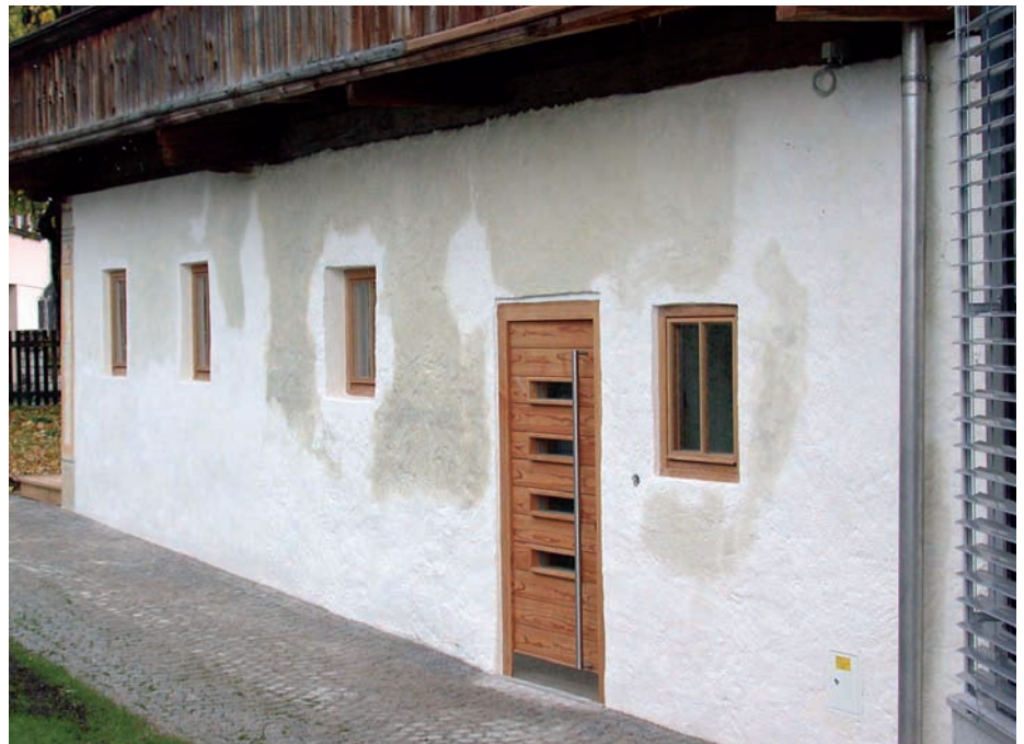
4 An diesem Bauernhaus in Nordtirol wurden intensive Massnahmen zur Reduktion der Salzbelastung im Fugennetz der Mauer gesetzt. Aufgrund der hohen Belastung war es aber nicht möglich, die Salzverbindungen völlig zu entfernen. Durch die richtige Materialwahl kann aber trotzdem ein «funktionierendes» Bauwerk sichergestellt werden.
