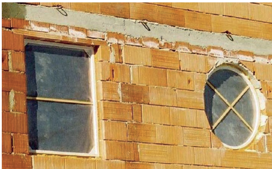
Mit Folien verschlossene Fensteröffnungen behindern den Abtransport von feuchter Innenluft und damit den Austrocknungsprozess.
