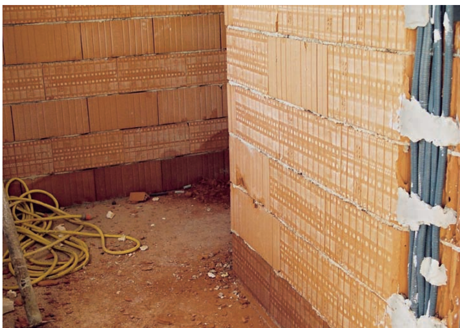
Von aussen eindringender Niederschlag wird in den Wandbaustoffen (auch in denen der Zwischenwände) eingelagert.
