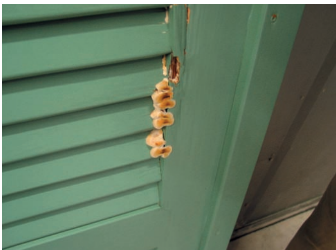
4 An derselben Terrassentür zeigte sich im ungeschützten Eckbereich ein starker Pilzbewuchs.
