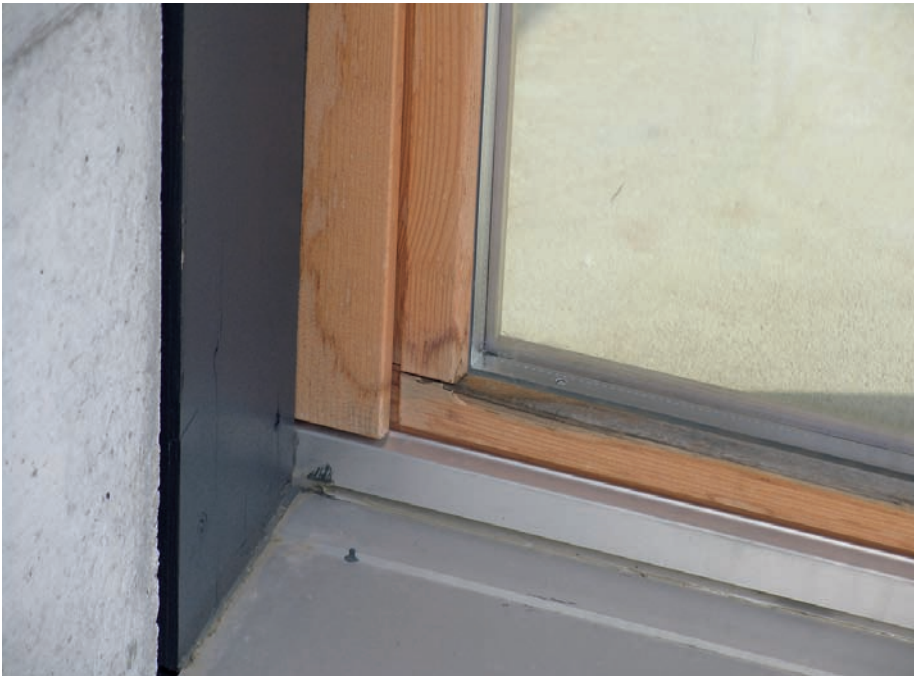
6 Wegen konstruktiver Mängel, eines ungenügenden Feuchteschutzes des Stirnholzes sowie fehlender Pigmentierung der Beschichtung zeigten sich bei diesem Fenster schon nach wenigen Monaten Nutzungsdauer Wasserflecken und eine starke Abwitterung der Wetterleiste.
