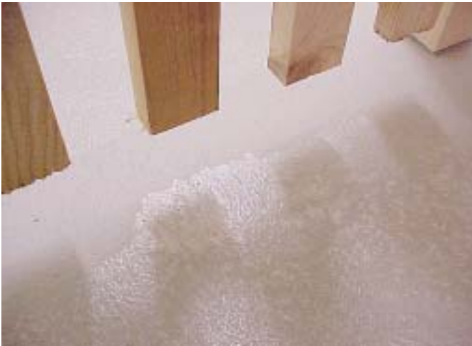
Eine mangelhafte Be- und Entlüftung während der Trocknungsphase kann Glanzunterschiede zur Folge haben.
