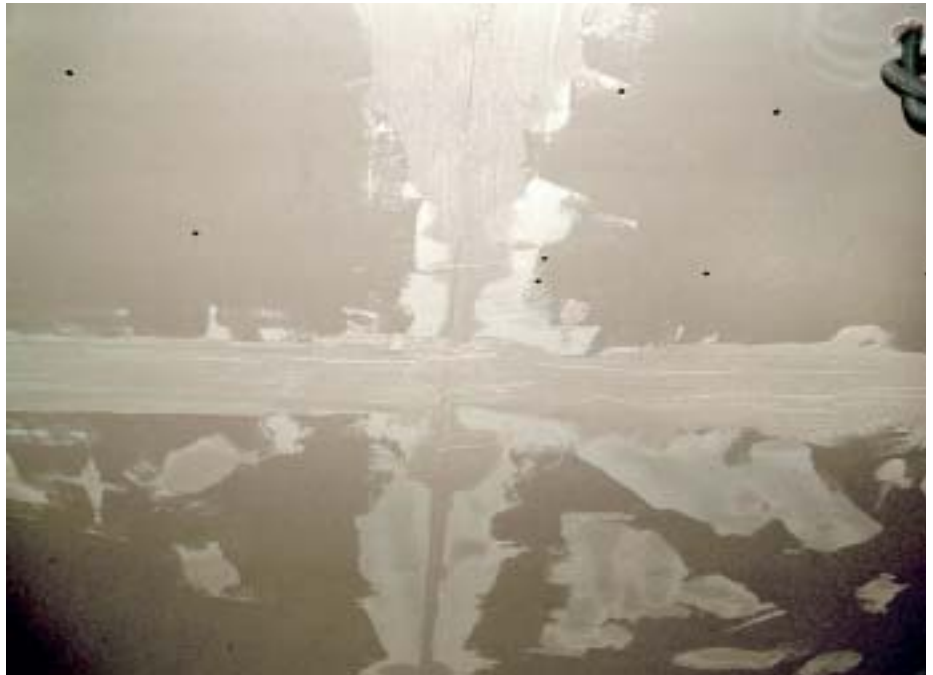
Nicht fachmännisch ausgeführte Spachtelung.
