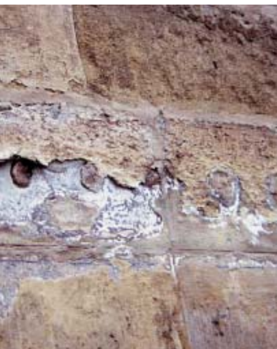
Reparaturversuche mit Steinersatzmörtel versagen auf salzhaltigem Untergrund
