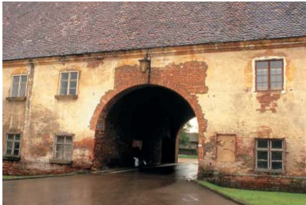
Klosteranlage Rot vor der Sanierung: Stallbereich mit rein hygroskopischer Feuchtigkeitsbelastung
