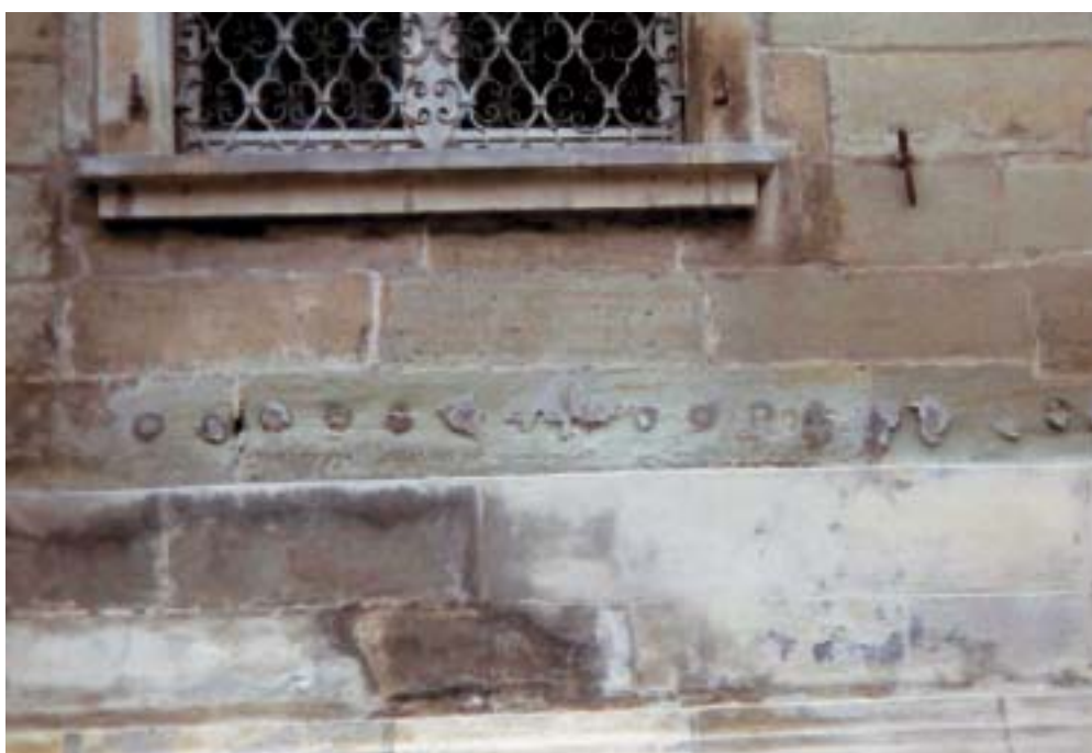
Massive Steinschäden an der Kirche in Lindau aufgrund salzbildender Injektion mit Wasserglas/Methylsilikonat
