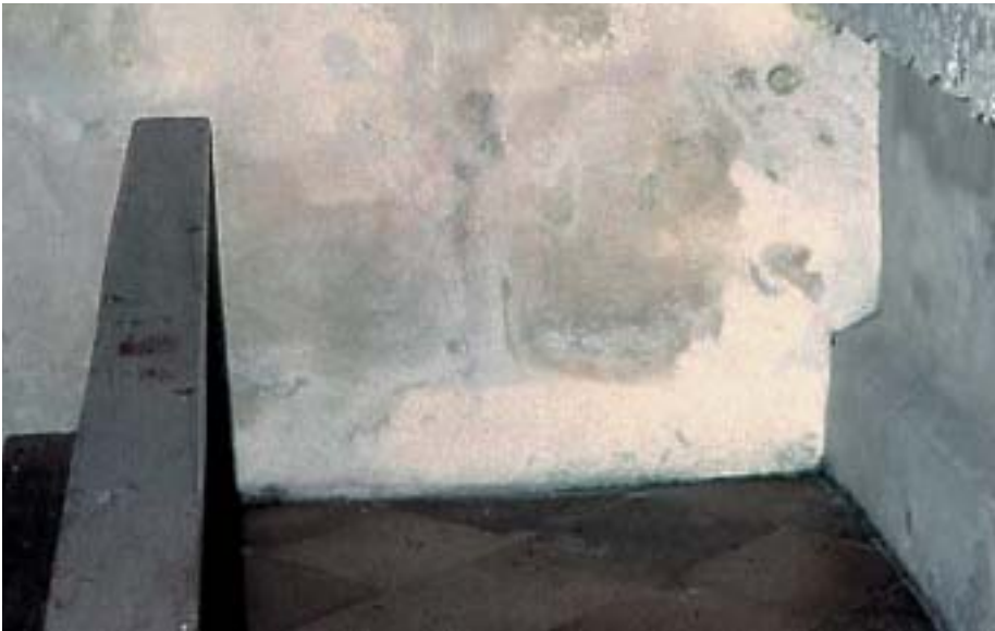
Beim Kloster Rot wurden die Gewölbe nicht mit Sanierputz verputzt, weshalb sich schon nach neun Monaten erste Schäden zeigten
