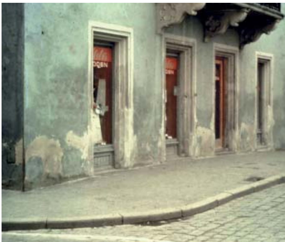
Bei feuchten Putzoberflächen gilt es, zwischen kapillarer (aufsteigender) und hygroskopischer Feuchtigkeit zu unterscheiden. Welche Ursache vorliegt, kann nur durch Untersuchungen geklärt werden
