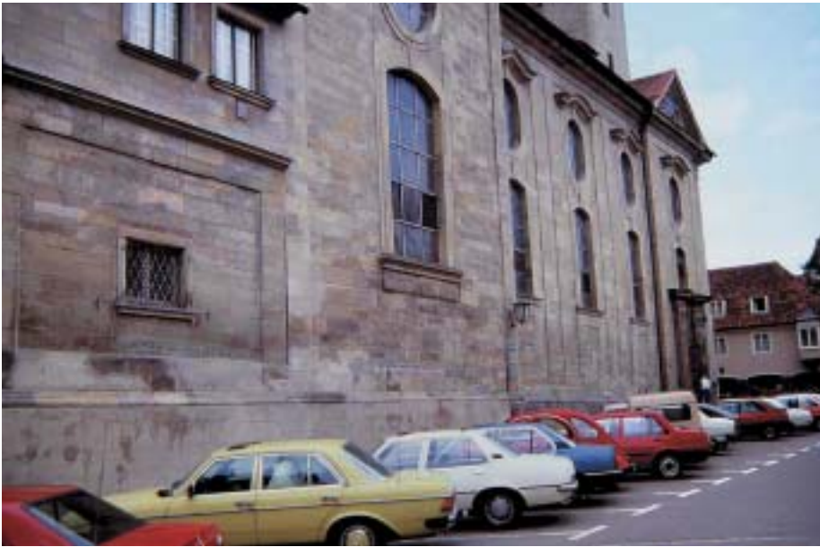
Kirche in Lindau, zwölf Jahre nach der Trockenlegung mittels druckloser Injektion: Die Feuchtigkeitsschäden sind schlimmer als je zuvor
