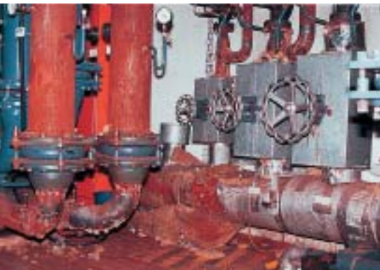
Stark von Rost betroffene Kaltwasserleitung im Pressehaus von Gruner + Jahr in Hamburg vor der Sanierung mit noverox
