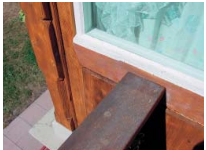
Handlauf nach acht Jahren Bewitterung. Kein Abblättern, aber gleichmässig abgebaut
