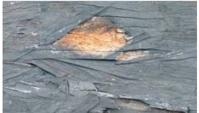
Fassade mit OSB-Platten, ohne baulichen Schutz: Durch die freie Bewitterung haben die oberste Spanlage und die Stirnseite Wasser aufgenommen und zeigen entsprechende Quellschäden (unten links). Gleichzeitig wird Pilzbefall festgestellt
