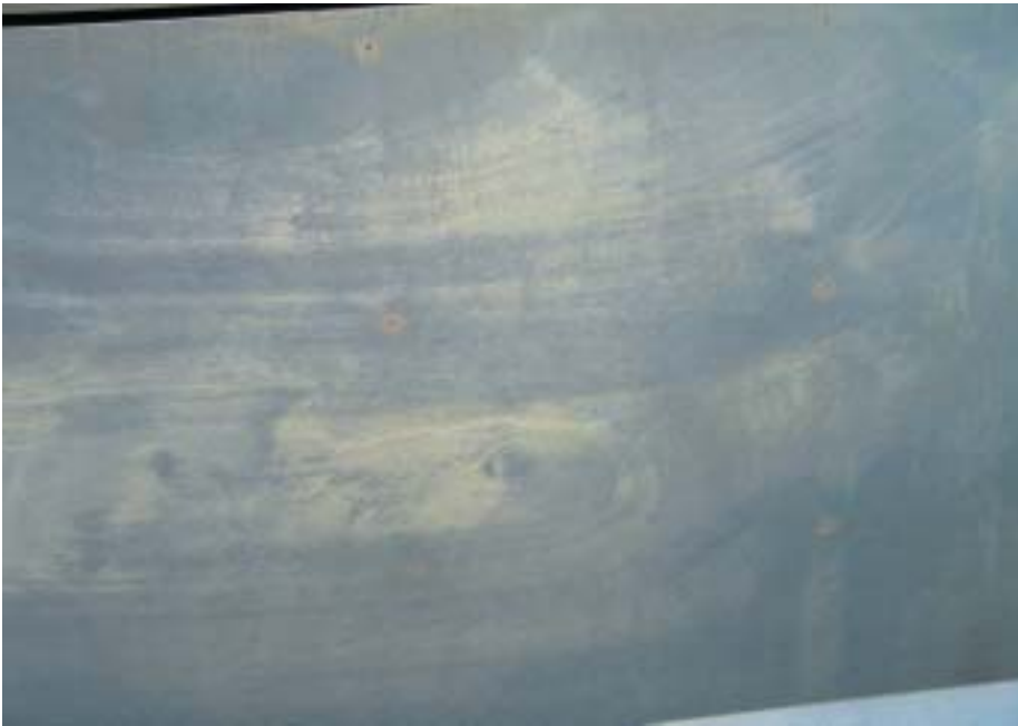
Multiplex Okume-Fassadenplatten mit grauer Lasurbehandlung: Leimstellen und unterschiedliche Oberflächenstruktur haben zur ungleichen Aufnahme und zum Aufschwemmen der Lasur geführt
