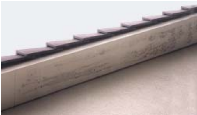
Nach einem Jahr zeigt sich an dieser Untersicht aus Zementspanplatten mit lösemittelhaltiger Alkydharzgrundierung massive Verseifung durch Feuchtigkeitsbelastung (Nebel) und Alkalität
