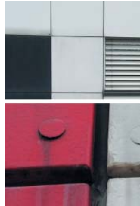
Melaminharzgetränktes Sperrholz, gestrichen mit 2-K Epoxigrundierung, Acrylgrund und Acryl nach vier Jahren: Deutliche Schäden bei gespachtelten Befestigungsschrauben (oben links) sowie starke Verschmutzung des thermoplastischen Acrylanstriches, ausgehend von den Fugendichtungen
