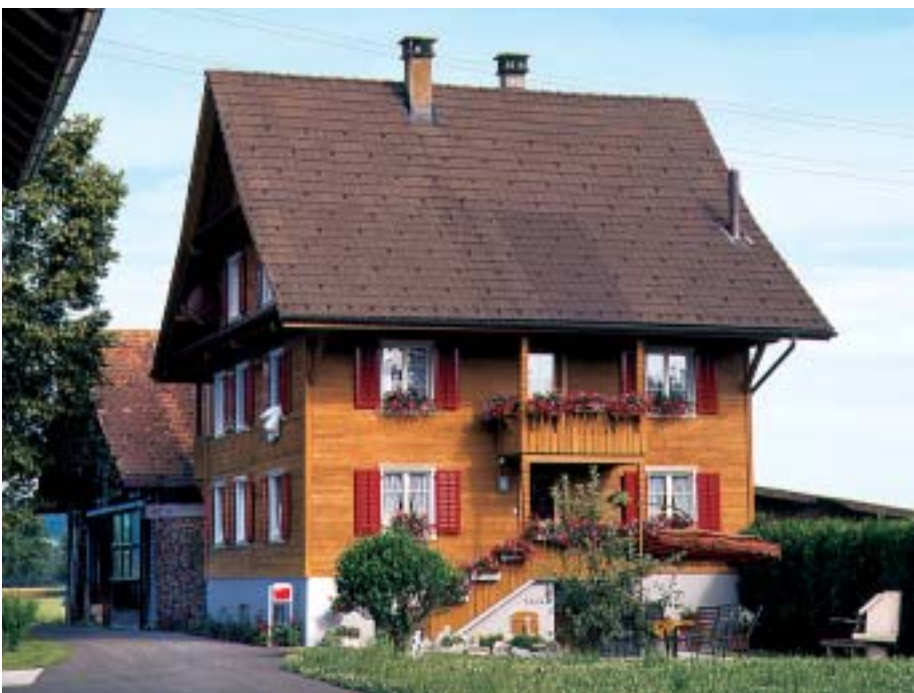
Chalet in Dietikon ZH: Holzfenster sind oft stark der Witterung ausgesetzt. Ungeschützt können sie daher rasch Schaden nehmen
