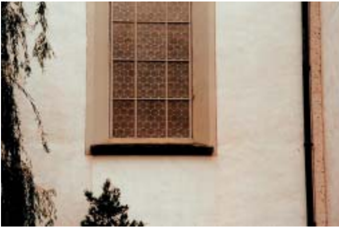
Starker Algenbefall an der Fassade
