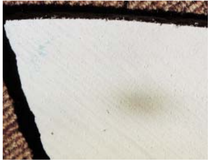
Stark verdünnte Haftbrücke, zu feuchter Beton führten zum Absturz des Deckenputzes
