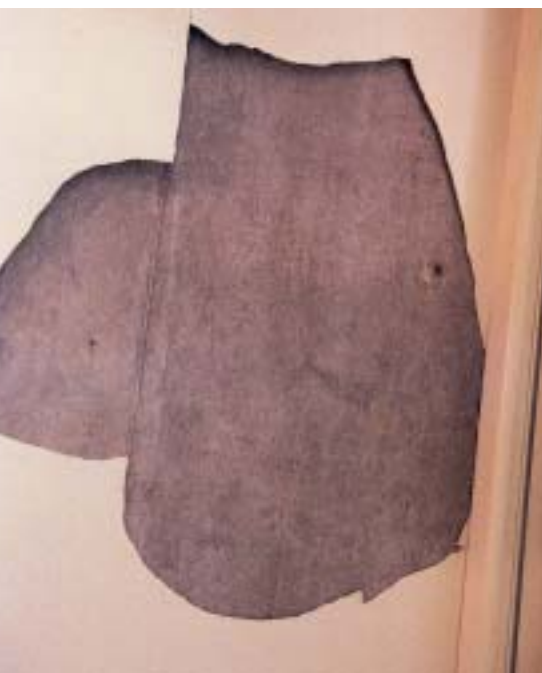
Sehr glatter Beton. Haftbrücke fehlt. Die Putzdicke beträgt 1,2 bis 2,0 mm. Deckenputzablösung ist vorprogrammiert
