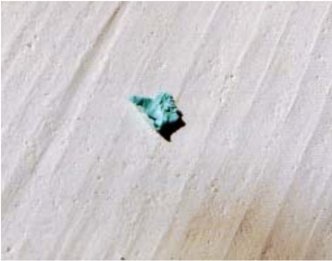
Glatte Ablösung des gesamten Deckputzes, weil Haftbrücke zu stark verdünnt wurde
