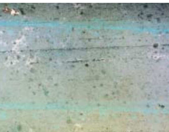
Zu stark verdünnte Haftbrücke. Die Körnung blieb im Eimer. Am Beton war nur noch Bindemittel vorhanden
