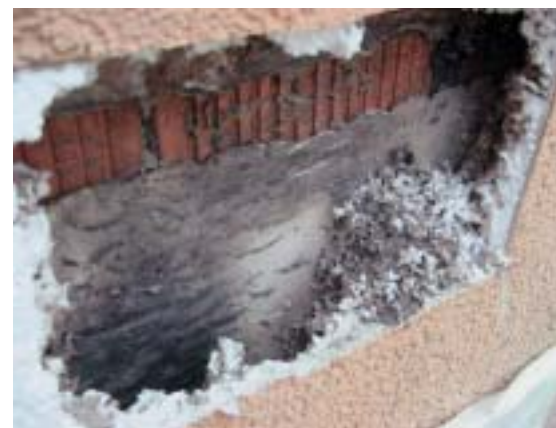
Schaden infolge undichten Terrainanschlusses: Dämmstoff durch Ameisen zerstört
