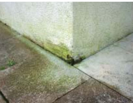
Ablösungen infolge ungenügender Detaillösung (Abdichtung)
