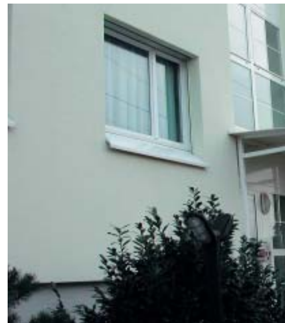
Wärmedämm-Verbundsystem mit einem zweimaligen Sto-Fungasil-Anstrich, vier Jahre alt
