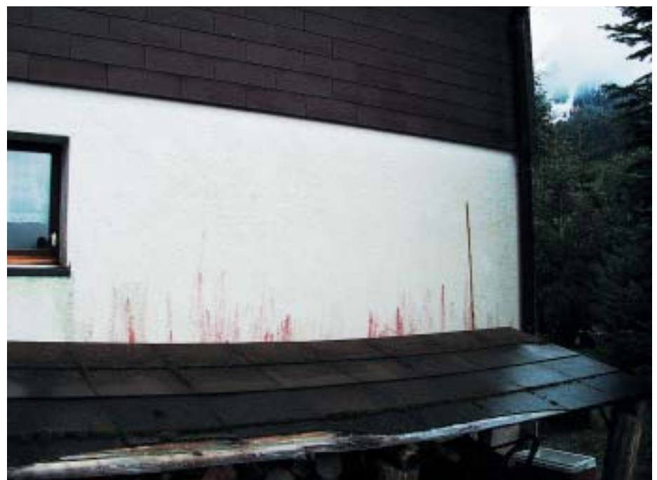
Abb. 6: Chalet in der Innerschweiz. An dieser Fassade sind keine flächigen, sondern nasenartige Wuchsbilder vorhanden. Es handelt sich um die von Schlagregen betroffene Wetterseite, deren oberer Teil noch von einem Vordach geschützt ist; daher beginnen die «Nasen» erst ab etwa 1,60 Meter Höhe
