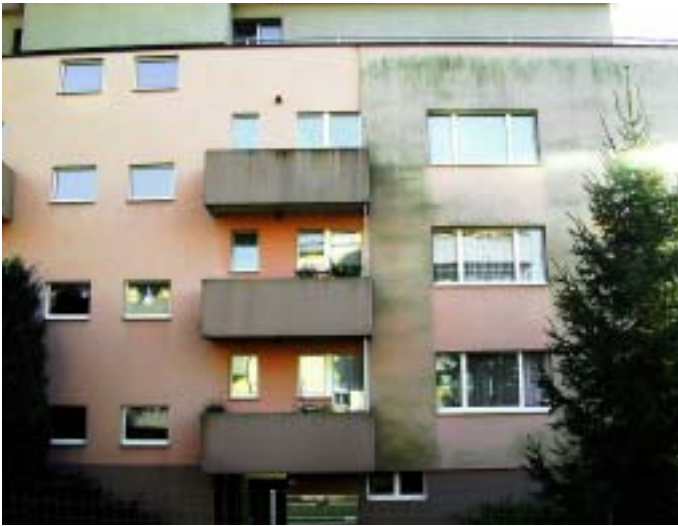
Abb. 4: Nördlich exponierte Fassade eines Wohnhauses: Die rechte Hausseite ist wärmegeklämmt (Wohnbereich); die Oberfläcbe ist mit einem vorwiegend Algen enthaltenden Biofilm bewachsen. Links im Bild sind die KÜchen und das Treppenhaus untergebracht; hier wurde auf Wärmeklämmtung verzichtet
